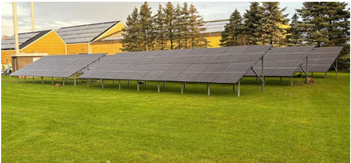
Ansøgers indsendte foto af den ansøgte type af anlæg og opstilling.
